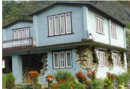
Ein beschädigtes Wohnhaus
